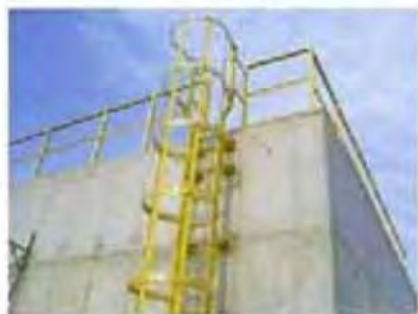
Escada Marinheiro instalada
