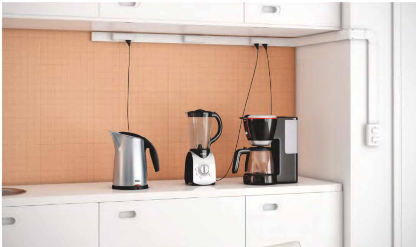
Canaleta sem tampa + Porta Equipamentos
