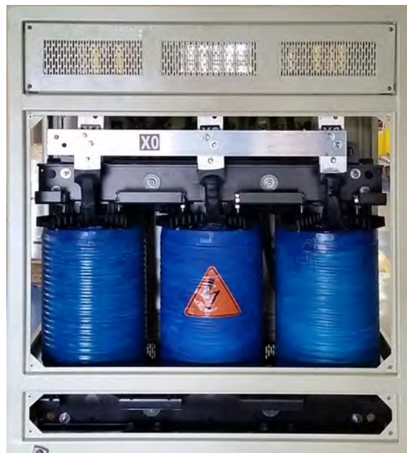
TRANSFORMADOR A SECO DE BAIXA TENSÃO
